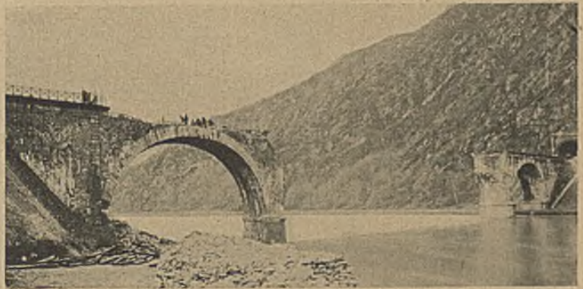
Abbildung 13. Zerstörte Eisenbahnbrücke in Laifour.
