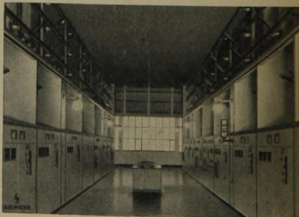
Abb. 5: Bedienungsgang einer neuzeitlichen Schaltanlage.
