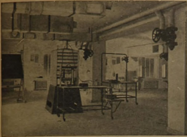
Abb. 13: Blick in den Ofenraum des Gaswärme-Institutes (Photo: VIW)
