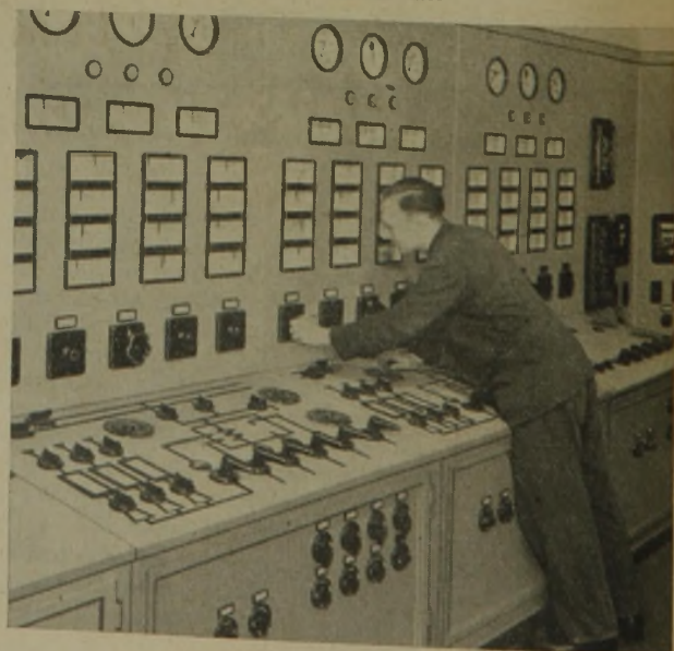
Abb. 14: Wärmewarte eines Industriekraftwerkes
