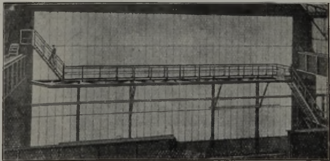
Abbildung 5. Kranaufstieg an der Stirnwand des Gebäudes unter praktischer Verwendung des Windverbandes der Stirnwand.
