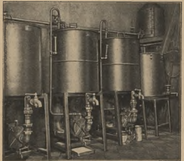
Bild 4. Anlage zur Herstellung der Emulsion.
