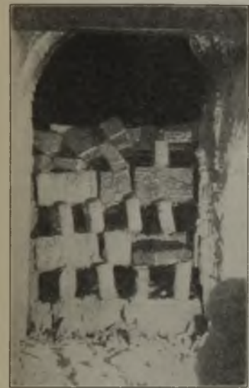
Abbildung 2. Eingefallenes Gitterwerk bei gewöhnlicher Ausgitterung.
