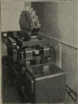
Abbildung 9. Schnellschalter in einer Bahngleichrichteranlage.
