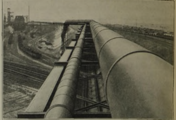
Abbildung 18. Mündung der in Abb. 14 bis 17 dargestellten 3,5 km langen Gasfernleitungen auf der Zeche. Die Leitung dient zum Austausch von Gichtgas und Hochofengas zwischen dem Hüttenwerk der Dortmunder Union und der Zeche Hansa. (Beachte die Ueberführung auf Brücken über die Gleise.)
