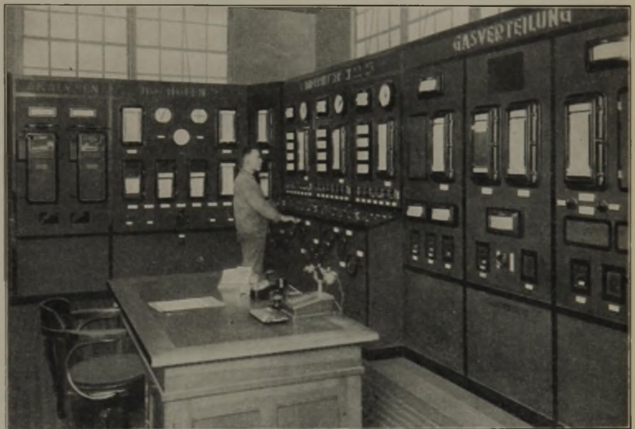
Abbildung 43. Meßhaus des Hochofenwerkes Bergeborbeck. Sichtbar sind: Mittelfeld für die Gasverteilung, je ein Feld für jeden der drei Winderhitzer des Hochofens II, ein Feld für Windmengen-anzeige, -regelung und Rückmeldung sowie die Sondenschreiber des Hochofens II, ein Feld für die Gichtgasanalyse beider Hochöfen.
