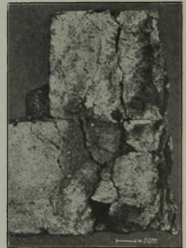
Abbildung 2. Lagenweises Abplatzen an Schachtsteinen, verursacht durch Versinterung.
