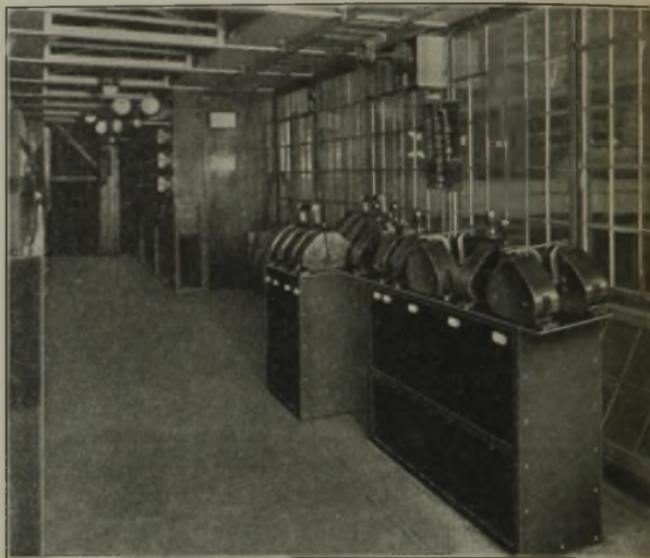
Abbildung 4. Vereinigung von Befehlsschaltern auf einem Schaltpult.
