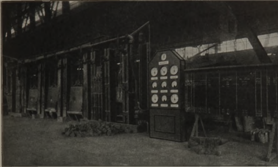
Abbildung 1. Meßtafel eines Siemens-Martin-Ofens.
