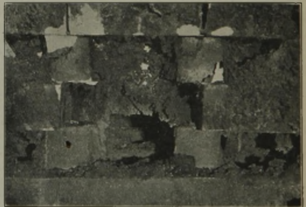
Abbildung 6. Durch Flugstaub zugesetzte Schamottepackung.
