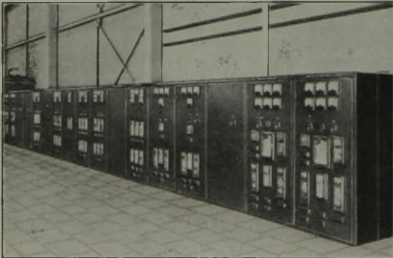
Bild 6. Stahlblechgekapselte Hochspannungs-Schaltanlage für 6 kV.
