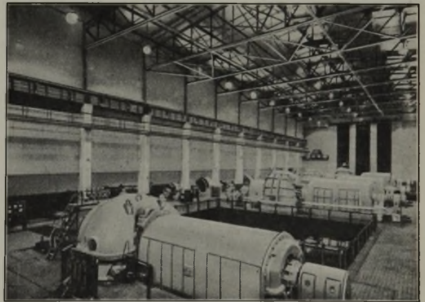
Bild 4. Turbosätze des Delray-Kraftwerkes, 4 × 25 000 kW.
