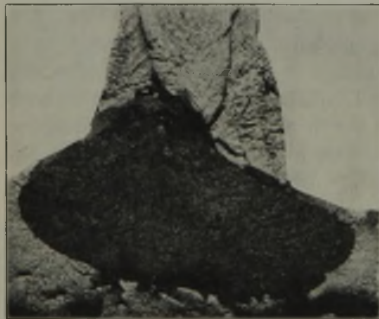
Bild 2. Anbruchfläche aus einem Träger der Zoo-Brücke.
