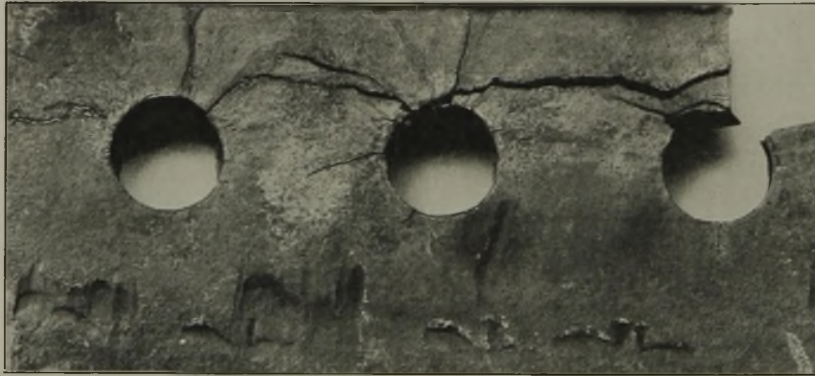
Bild 3. Risse an den Nietlöchern eines Flammrohrkessels. ( \times \frac{3}{4} .)
