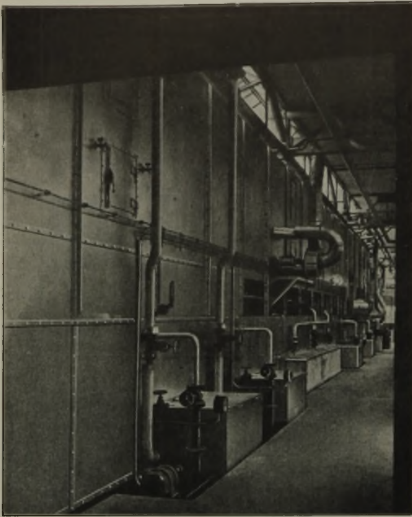
Bild 11. Gesamtansicht einer selbsttätigen Bonder- und Lackieranlage.
