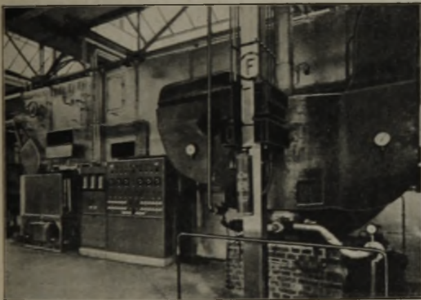
Bild 15. Schaltstelle der Anlage nach Bild 11.
