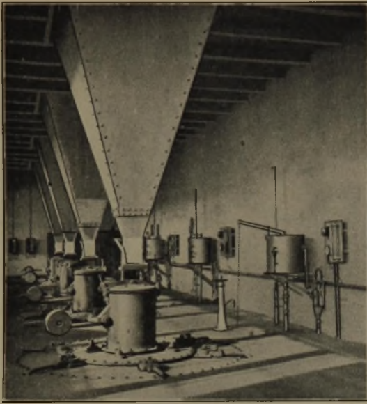
Bild 4. Gaserzeugeranlage für teearme Brennstoffe mit Beschickung von einem Hochbunker aus.
