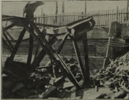
Abbildung 16. Knicung des ersten Obergurtwinkels bei Pfosten 16 (s. Abb. 13).
