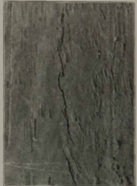
Bild 37. Spannungsriß in der Ecke eines Stahlgußkessels. (rd. \times 0,4 .)
