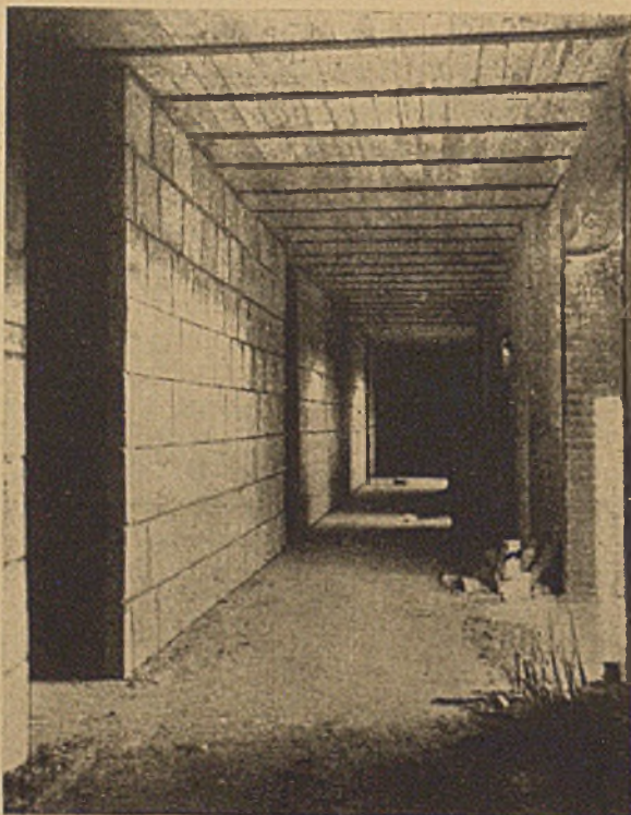
Isolierende Scheidewände aus Zellenbeton (Raumgewicht 0,4) mit armiertem Verputz auf beiden Seiten. (Kopenhagen)
