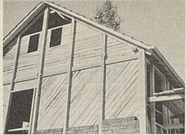
Haus 10 (Rich. Weber). Fachwerk mit durchgehenden Ständern, innenseitig mit Schrägschalung verspannt, zwischen den Ständern Backsteinausmauerung
