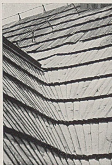
Riesengebirgsbaude, Kehldeckung mit konischen Langschindeln (Fotos Hanson) (Aus „Das Holzhausbuch“ v.G.Harbers, Verlag Georg D.W. Callwey - München)
