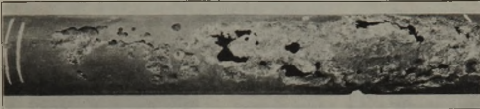
Bild 21. Zerstörungen durch Korrosion an einem Rohr aus dem Wärmeaustauscher einer Benzinschwelanlage.
