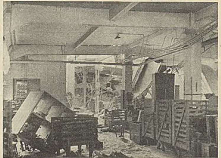
Abb. 6. Blick vom Binderfeld 6—5 nach der Zerstörungsstelle.
