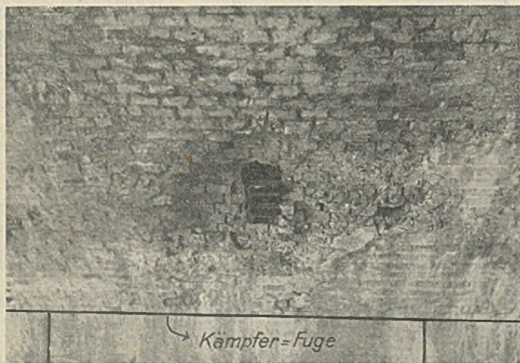
Abb. 2. Schadhafte Stellen des Gewölbes der Wersebrücke.
