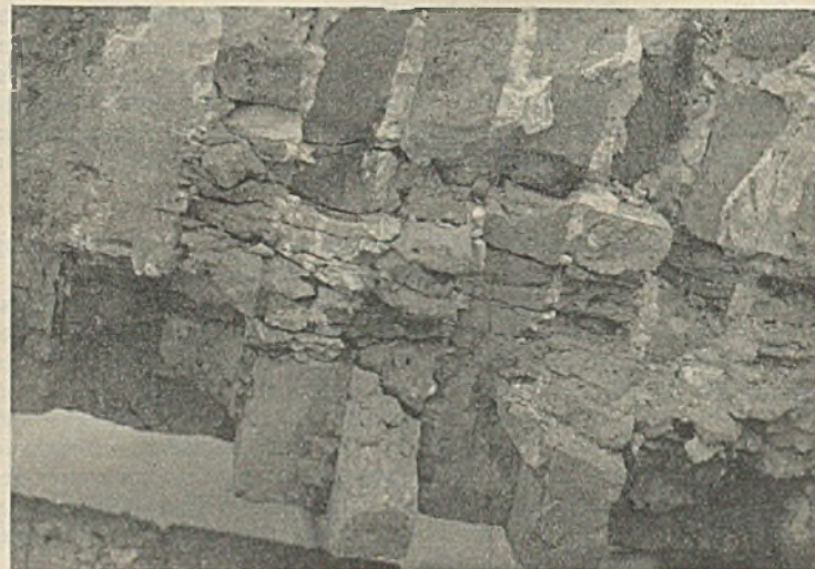
Abb. 3. Beim Abbruch festgestellte Zerstörung des Gewölbes der Wersebrücke.
