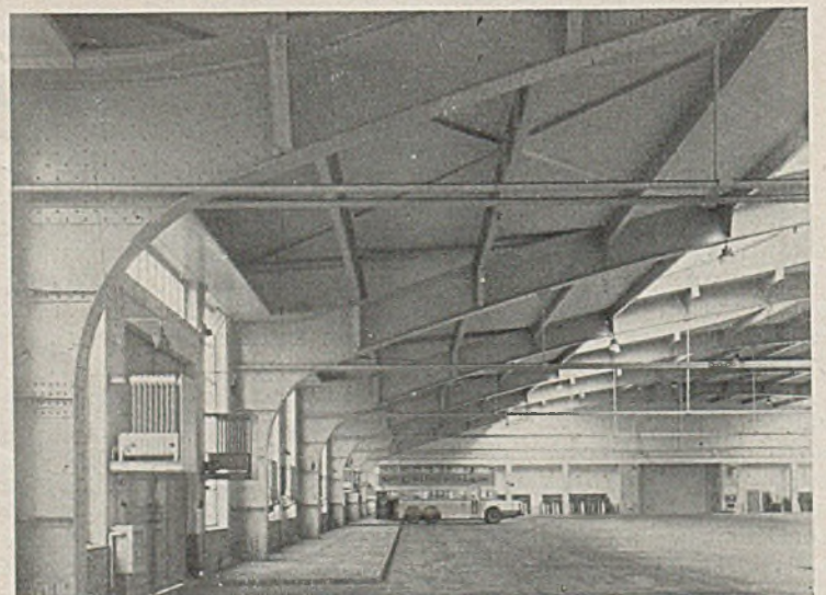
Bild 16. Halle III. Ansicht der Binderstiele mit Blick auf die Durchfahrt zur Halle II.
