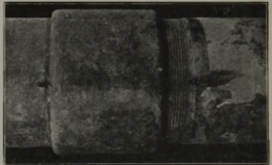
Abbildung 12. Erosionserscheinung an einem Gasleitungsrohr.
