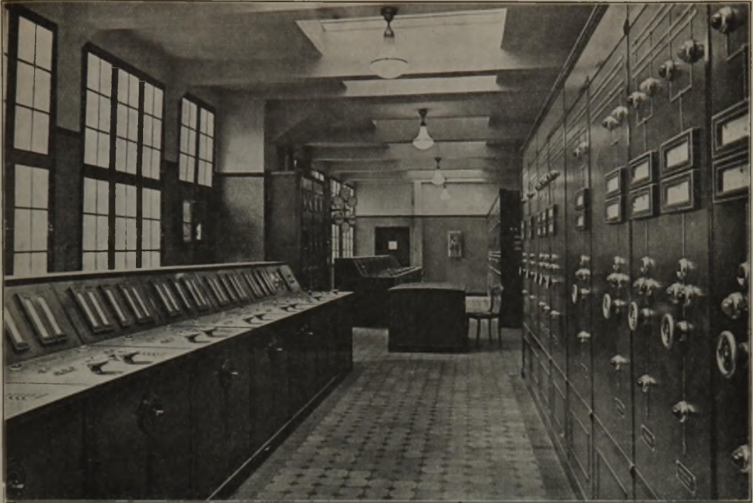
Abbildung 7. Schaltanlage eines Hüttenkraftwerkes.
