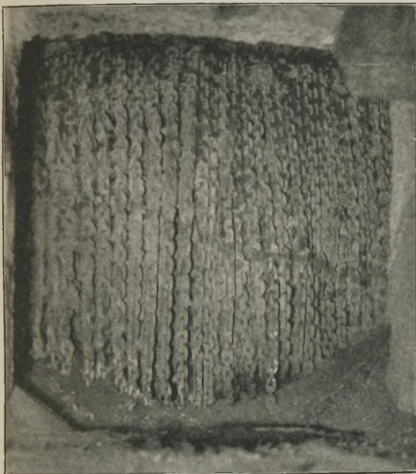
Abbildung 4. Staubansatz auf dem Kettenfilter nach 14 Betriebstagen.
