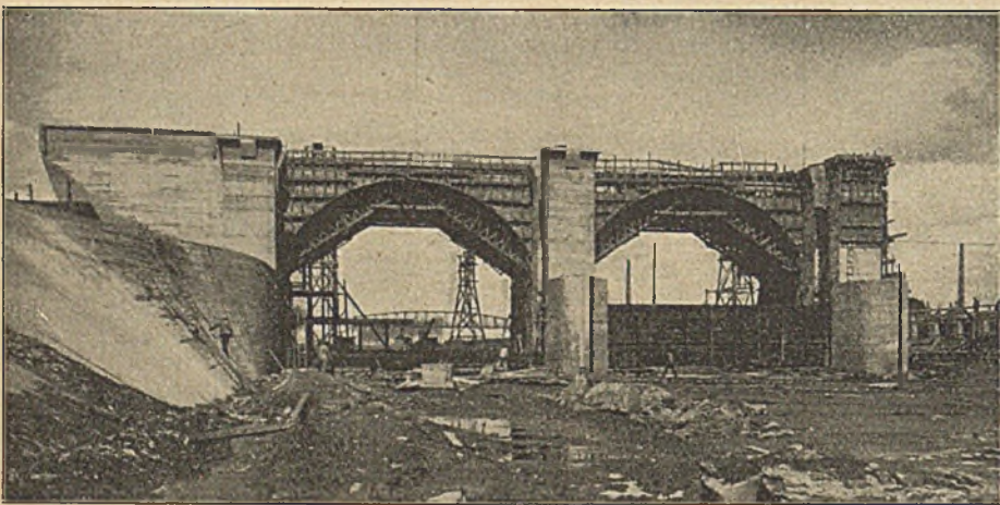
Abb. 3. Staustufe Neckarsulm, unterhalb Heilbronn. Schützenwehr und Straßenbrücke mit 4 Öffnungen von je 17 m Lichtweite im Bau.
