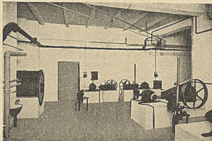
Abb. 12. Elektromotoren der Hebeanlage.
