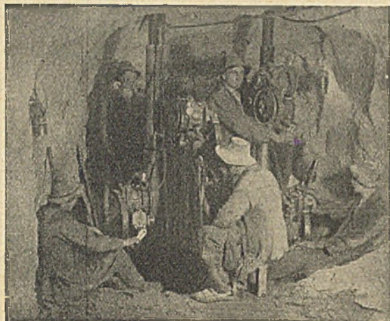
Abb. 55. Versuchsweise Verwendung von vier elektrischen Kurbel-Stoßbohrmaschinen an Spannsäulen beim Vortriebe des Ranna-Druckstollens.
