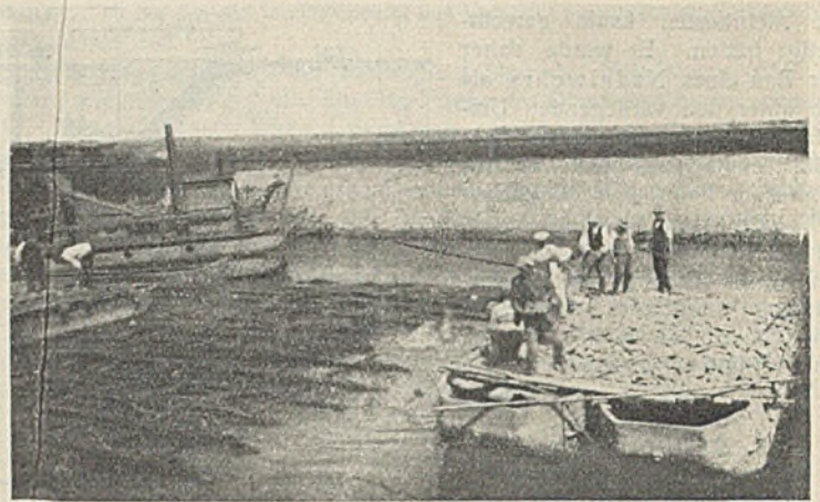
Abb. 8. Absenken eines Sinkstückes für die Sturzbettbefestigung der linken Wehrhälfte. Dahinter der Bagger bei Herstellung der Auskofferung für das Sturzbett (vom linken Ufer gesehen).
