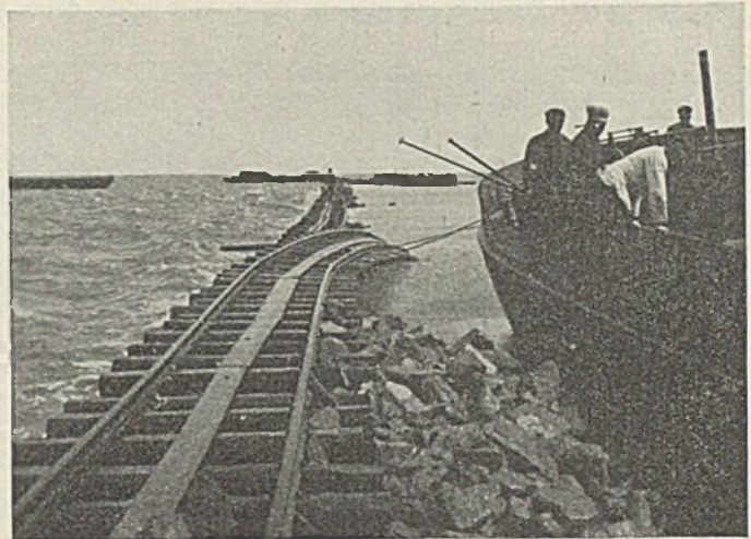
Abb. 10. Mit Schüttsteinen gesicherter Spundwanddamm bei Hochwasser. Das Gleis ist teilweise durch einen Nordweststurm herabgerissen.
