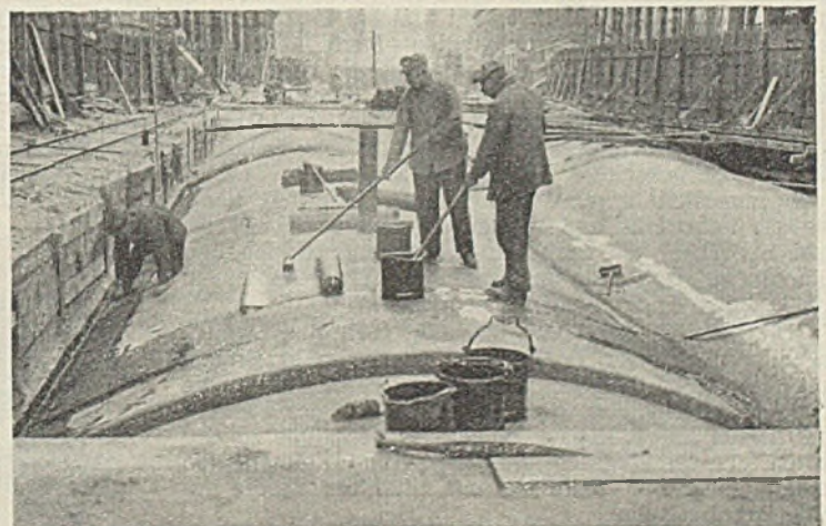
Abb. 4. Deckendichtung eines Untergrundbahntunnels in Berlin.
