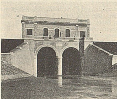
Abb. 48. Bonifica Parmigiana-Moglia. Schleuse bei Mondine. Ansicht gegen den Ablaufkanal.
