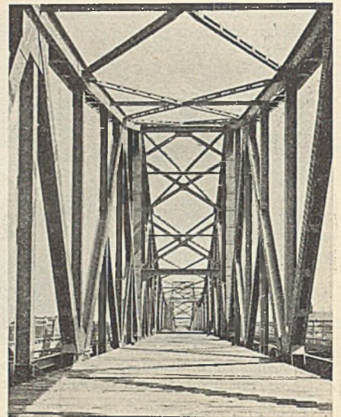
Abb. 9. Blick in das Innere der neuen Brücke. (Von der Fahrbahndecke sind nur die Belageisen aufgebracht.)
