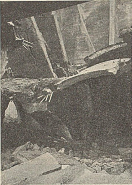
Abb. 5. Der gesprengte Pfeiler B4.
