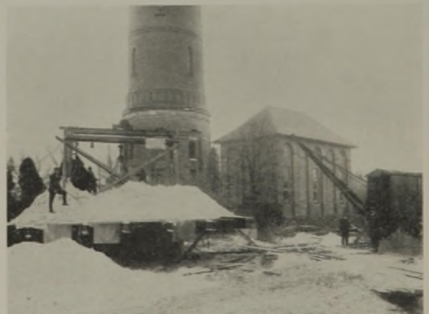
Abb. 5. Letzter Abschnitt der Absenkung. Arbeitsbühne mit Beschwerung; Greifbagger vom seitlich stehenden Dampfkran betrieben.
