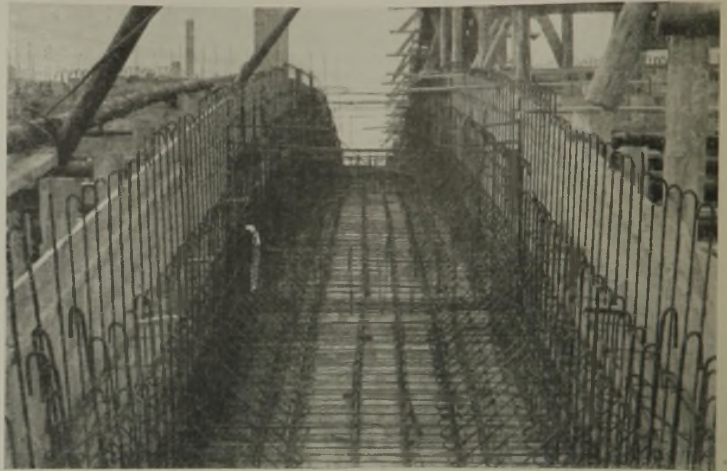
Abb. 18. Bewehrung der Bodenplatte und der Seitenwände eines Kastenträgers. Blick nach dem Scheitel.
