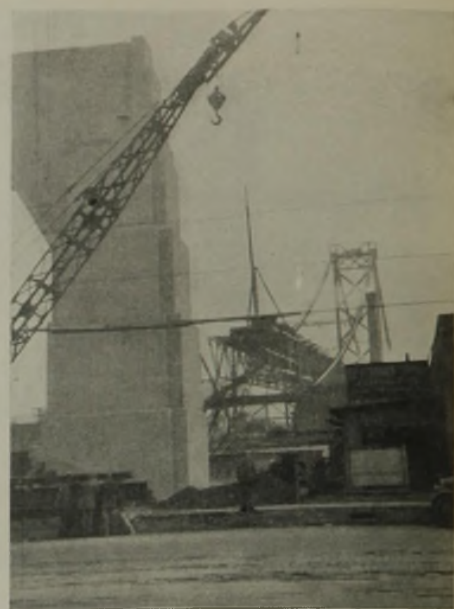
Abb. 14. Im Vordergrund Teil eines Betonwiderlagers der Brücke für das Überschreiten einer Verkehrsstraße.
