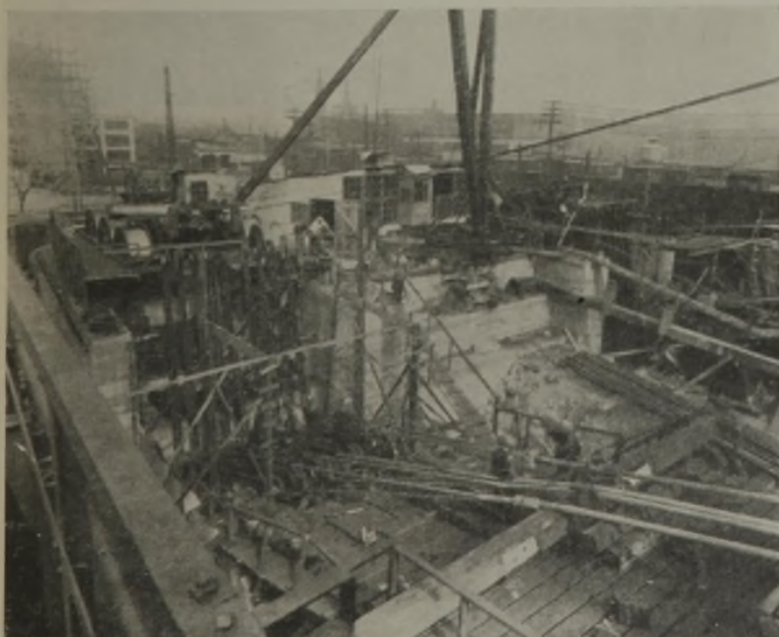
Abb. 11. Verankerungswiderlager auf der amerikanischen Seite. Im Hintergrunde links ein Betonwiderlager der Brücke in Schalung. Links im Vordergrund Rollen eingebaut mit Draht für das Spinnen der Kabel, Augeneisen und die ersten Kabelbündel.
