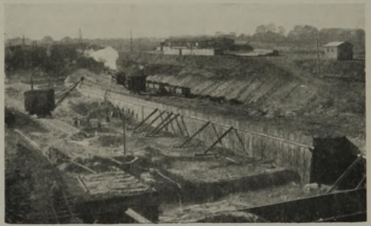
Abb. 11. Ansicht der ganzen Schleusenbaustelle. Zwei Kübelkrane heben den Boden aus zwischen den Spundwänden, auf schiefen Ebenen wird der Boden abtransportiert; rechts Lageplatz mit Schuppen und im Hintergrunde Kieshaufen.
