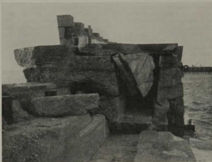
Abb. 4. Hafen Helgoland. Westmole bei Punkt 1100 durch Sturmflut stark beschädigt.
