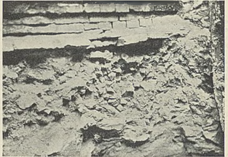
Abb. 30. Alte Schleuse Hüntel, Beschaffenheit des Schüttbodyens.
