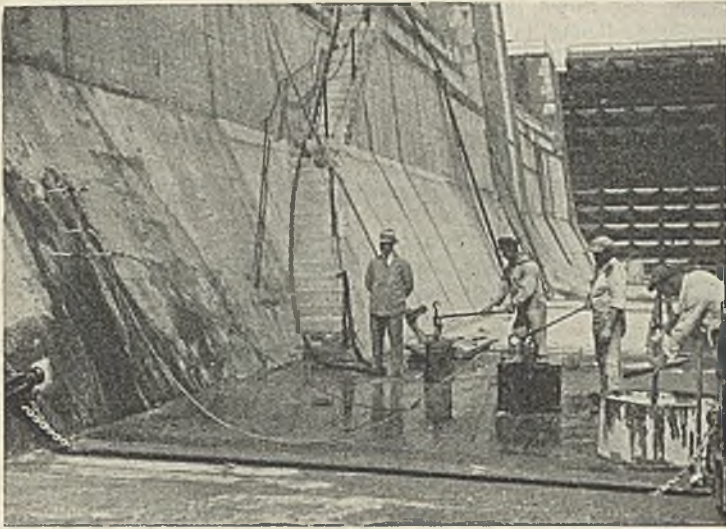
Abb. 13. Abdichtungsarbeiten im Dock VI in Kiel. Die in Abb. 12 dargestellte undichte Stelle während des Verpressens des Chemikals.
