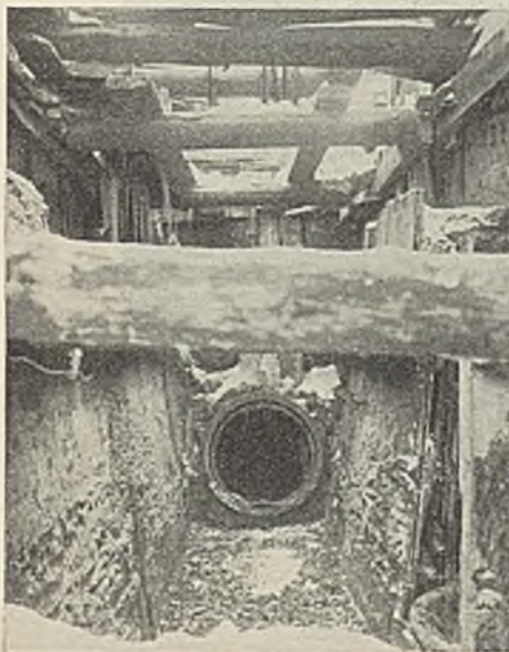
Abb. 6. Dükeranschluß am Ankelmannsplatz Hamburg unter Anwendung der chemischen Bodenverfestigung. Im Hintergrunde befindet sich die chemisch verfestigte Baugrubenwand, die von dem im unteren Teil sichtbaren Dükerhals durchbrochen wird.
