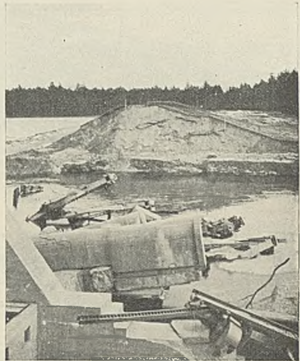
Abb. 4. Bruchstelle, links eingestürztes Entlastungsbauwerk.
