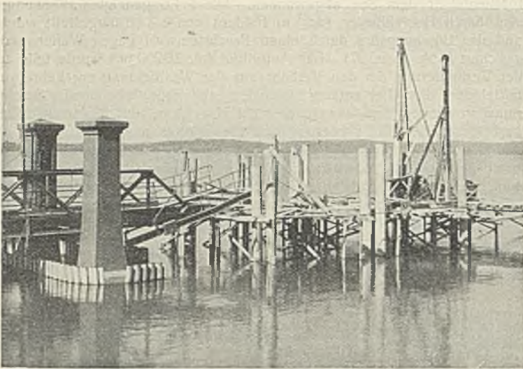
Abb. 25a. Hafenanlage Meersburg. Herstellung des inneren Leitwerks. Einbohren und Rammen der Holzpfähle.
