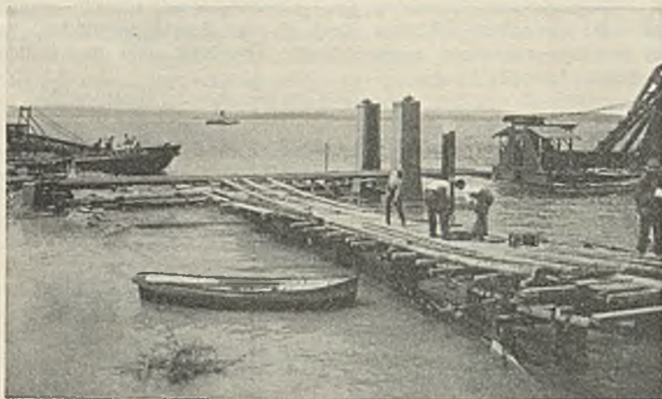
Abb. 33. Hafenanlage Meersburg. Montage der Landebrücke. Rechts der Schwimmbagger, links Löschen des mit Baggergut beladenen Motorlastschiffes.
