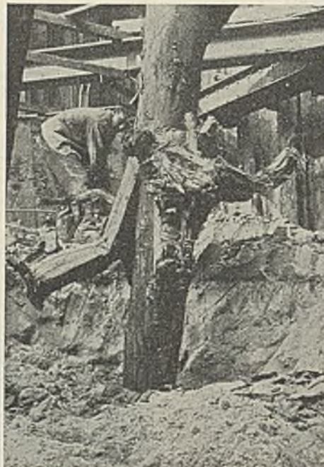
Abb. 15. Stark gestauchter Pfahl.
