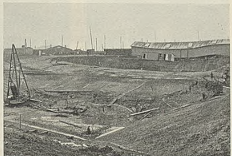
Abb. 12. Rutschung in der Baugrube der Dockverlängerung.
