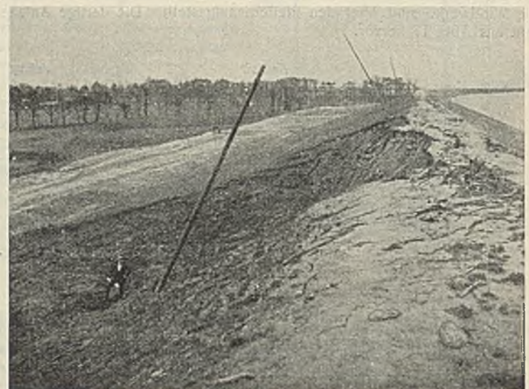
Abb. 22. Rutschung am Damm.
